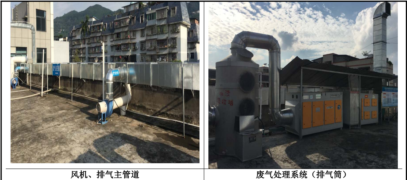
图 1-2 废气处理设施现状照片（综合楼 6F）
